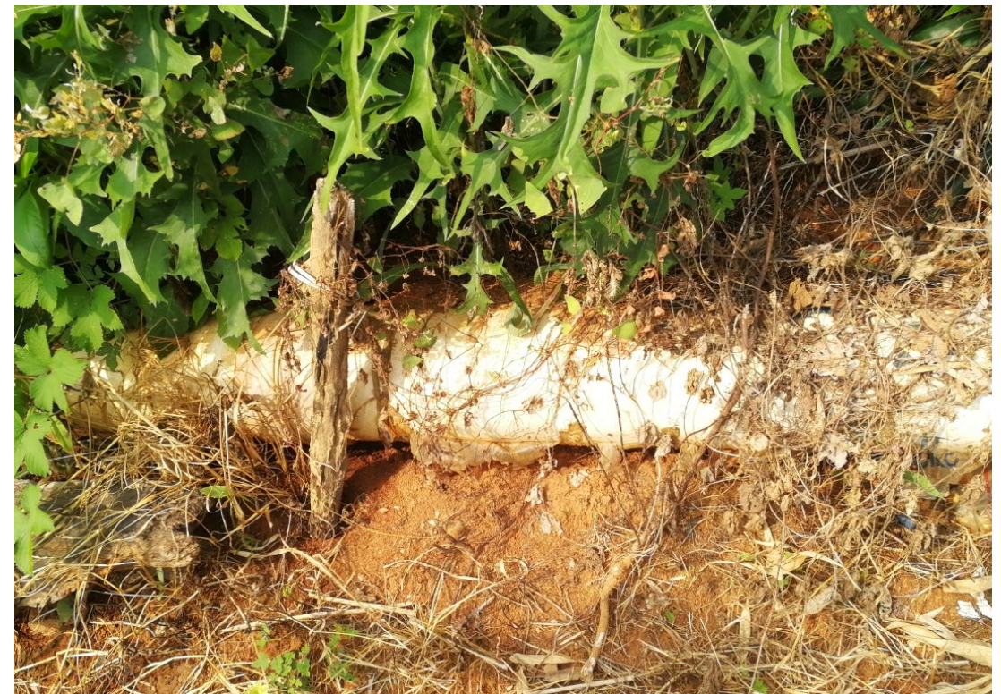
图 3.6 漕溪港上游水体沿岸居民排水管
