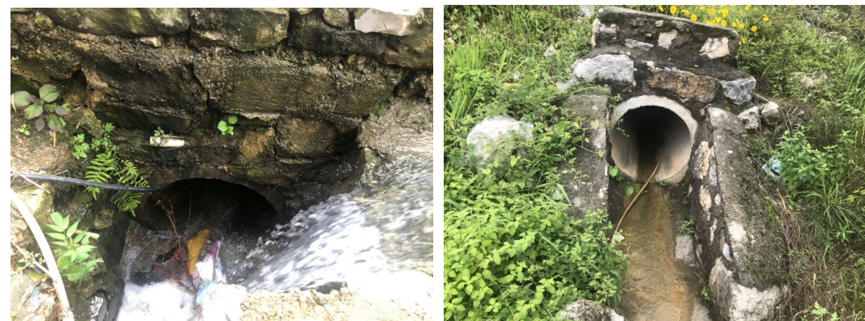
图 6-4 沿线老涵现状照片
