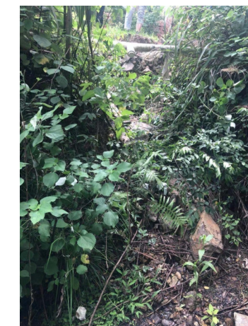
图 6-6 老涵破损堵死现状照片
