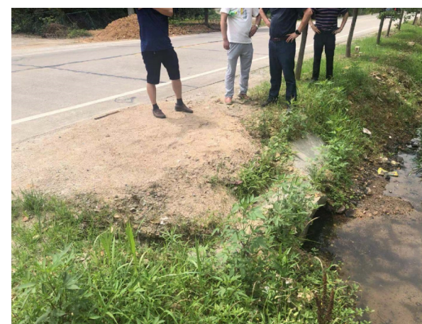
图 6-5 局部堵塞老涵现状照片
