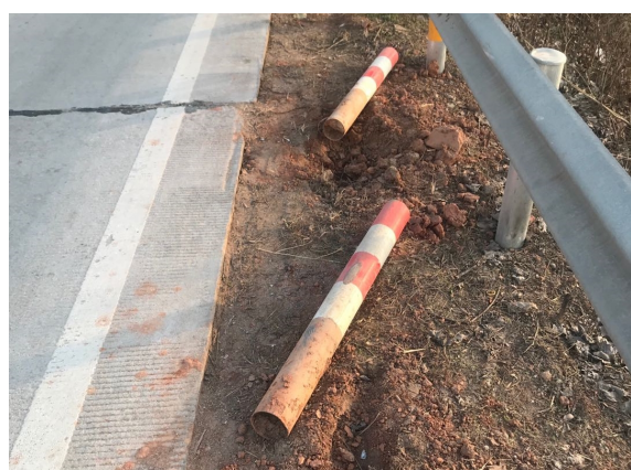
图 5-2 现状损坏道口桩
