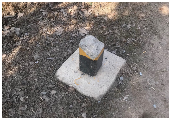
图 5-1 现状破损示警桩
